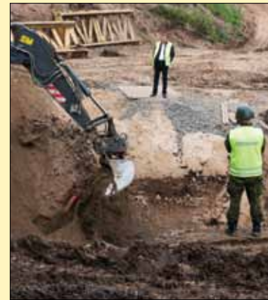
Grunto sluoksniu buvo apsaugoti greta nutiesti ryšių kabeliai.
