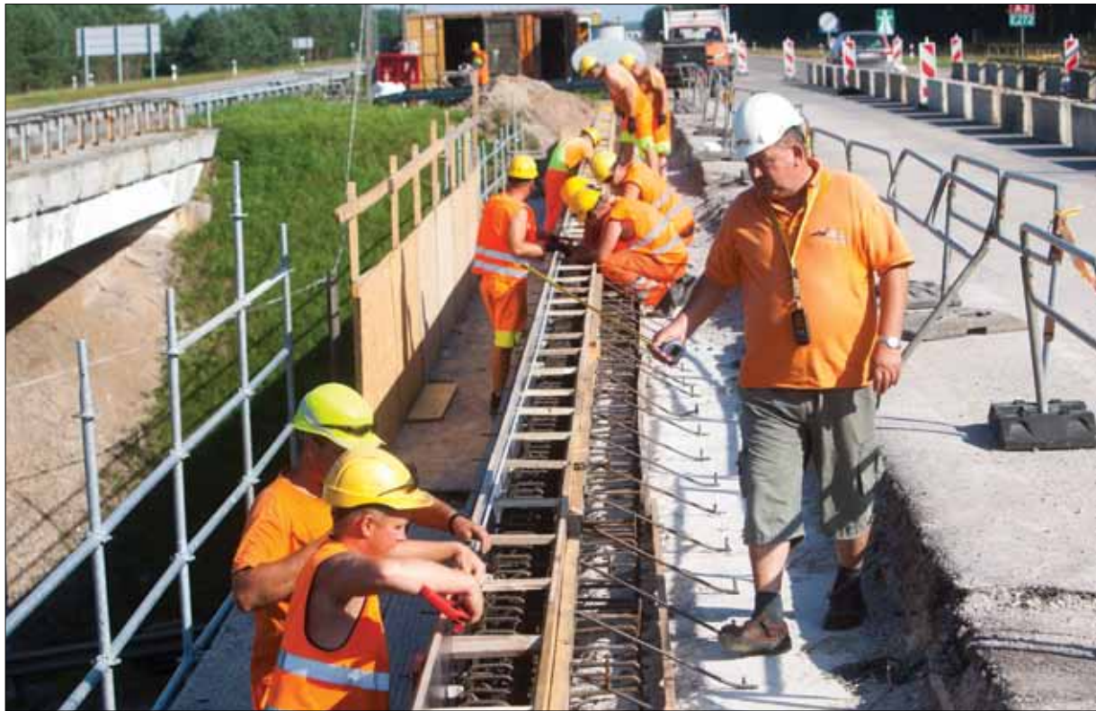
Nuo liepos 12-osios prasidėjo Dukstynos viadukų, esančių magistralės A2 Vilnius-Panevėžys 74,68 kilometre rekonstrukcija. Ten dirba Alvydo Makavičiaus vadovaujamas darbų vykdymo padalinys. Nuotraukoje - Jonas Albinas Janickas ir jo kolegos.
